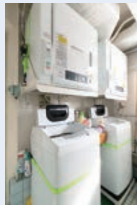
洗濯機・乾燥機
