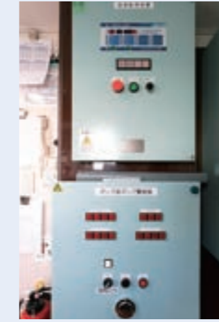
温度監視装置・ポンプ室ポンプ警報盤
