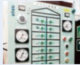
バラスト制御盤
